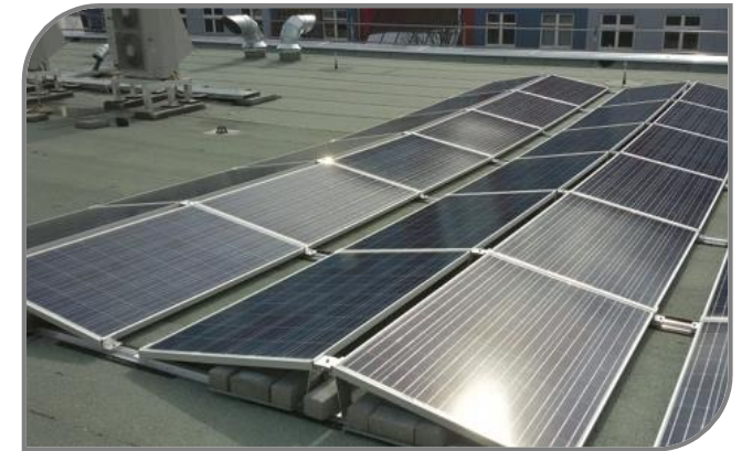
Ipari épület Németországban 49 kWp
