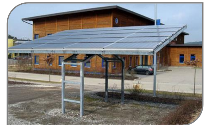
Kocsi beálló Németországban 4,2 kWp
