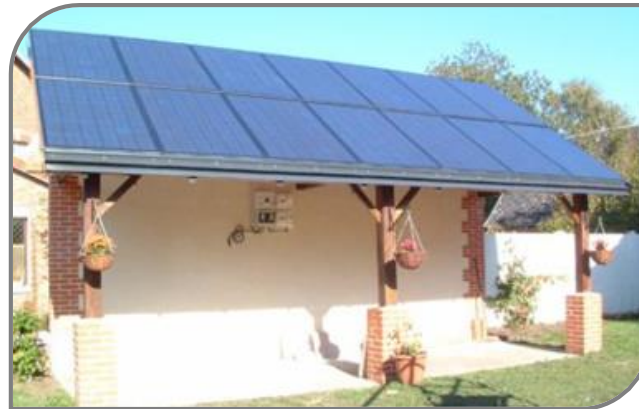
Féltető Franciaországban 2,94 kWp
