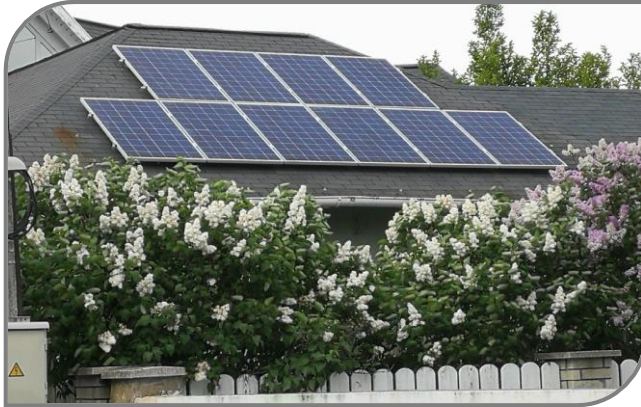
Ajka 2,7 kWp meleg víz rendszer, fűtőszállal
