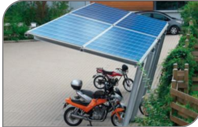
Motor és bicikli beálló Németországban 4,6 kWp
